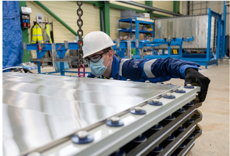
Foto: thyssenkrupp nucera
