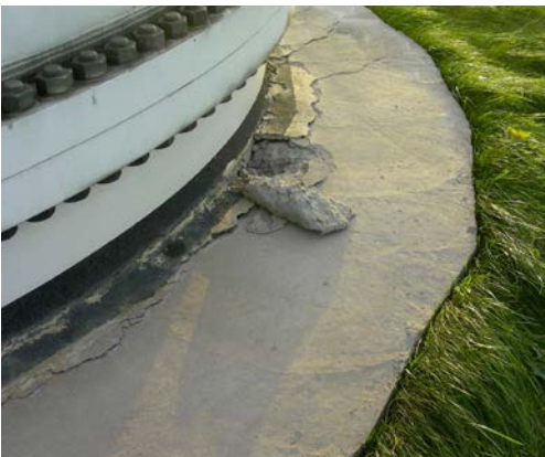
Sanierungsfall abgeplatzter Beton ...
